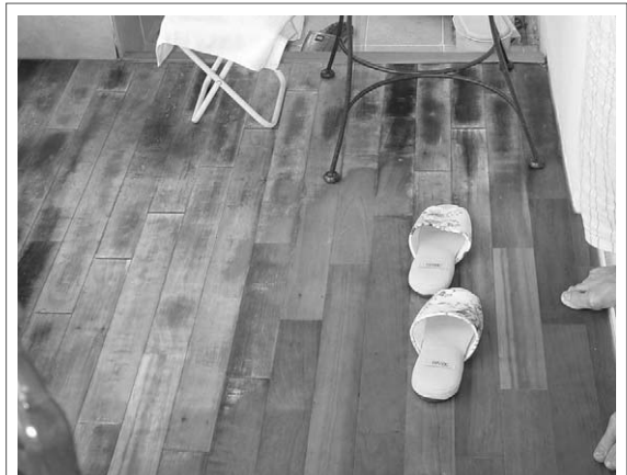
[그림 2] 발코니 확장 부위, 샷시 누수에 의한 전체적인 피해 상태
